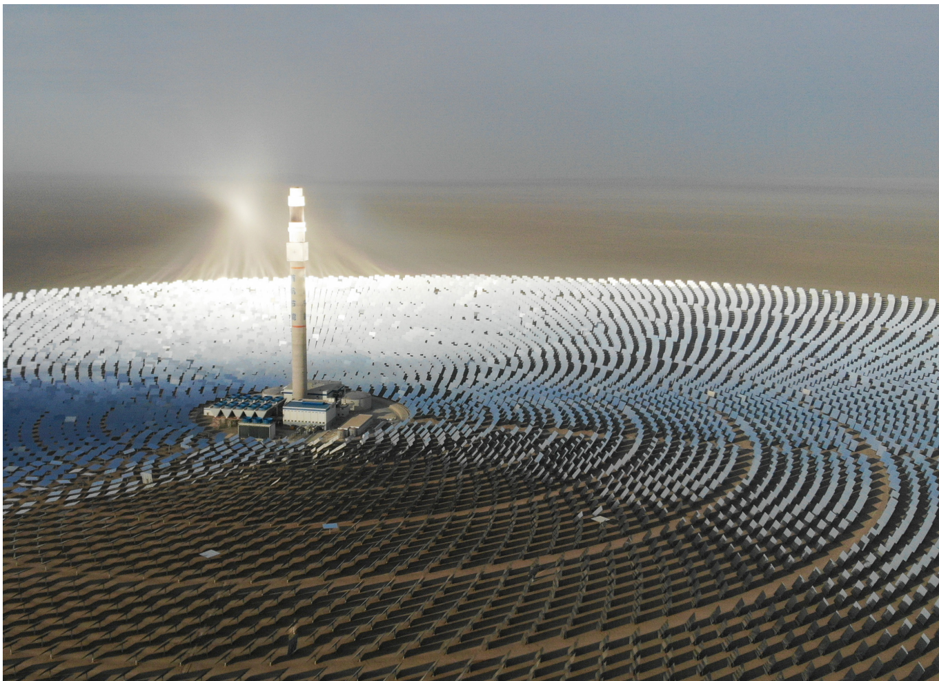
Photo prise le 24 février 2021 montrant une centrale solaire thermique à sel fondu à Dunhuang, dans la province du Gansu (nord-ouest de la Chine). (XINHUA)
