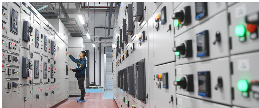
Un membre du personnel travaille dans un centre de données du géant des télécommunications China Unicom à Zhongwei, dans la région autonome Hui du Ningxia (nord-ouest de la Chine), le 1 er mars 2021. (XINHUA)
